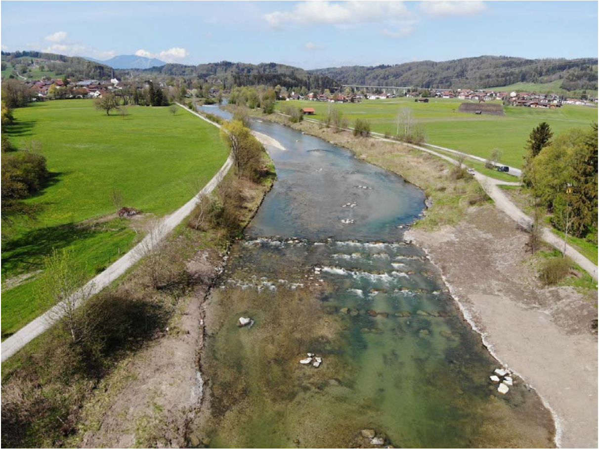
In eine naturnahe Sohlrampe umgebauter Absturz an der Loisach bei Großweil Bild: WWA Weilheim
