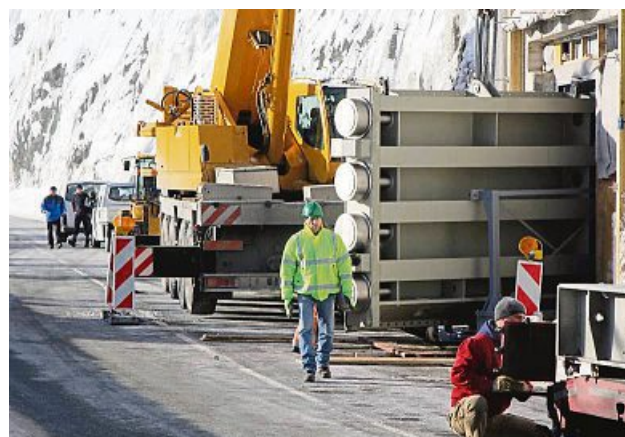
Hier wird eine der Schütztafel-Hälften in die Grundablasskaverne geschoben. Nach ihrem Einbau regulieren diese Stahltafeln die Menge, die im Hochwasserfall an die Isar abgegeben wird.
