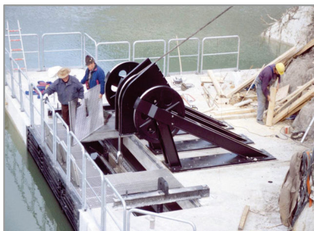
Arbeiten am Triebwasserstollen – über eine ähnliche Umlenkrolle soll auch der neue Revisionsverschluss bewegt werden
